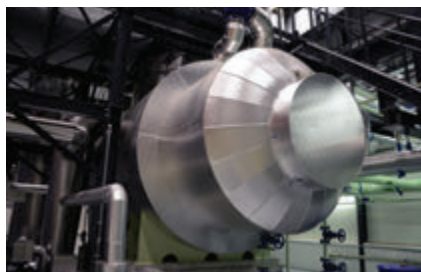
Obr. 5 – Topný výměník zapojený do horkovodní sítě CZT
