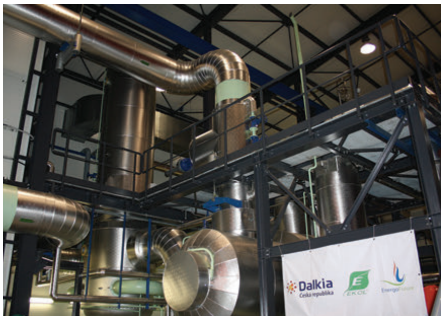
Snímek z kotelny bioelektrárny ve Sviadnově
