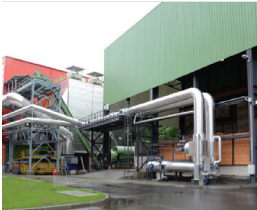
Obr. 1 – Pohled na skládku paliva a kotelnu bioelektrárny, v čele je horkovodní potrubí
