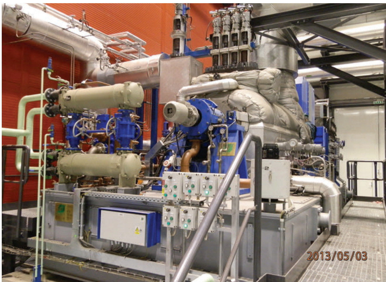
Obr. 3 – Turbína ve strojovně - ilustrační foto
