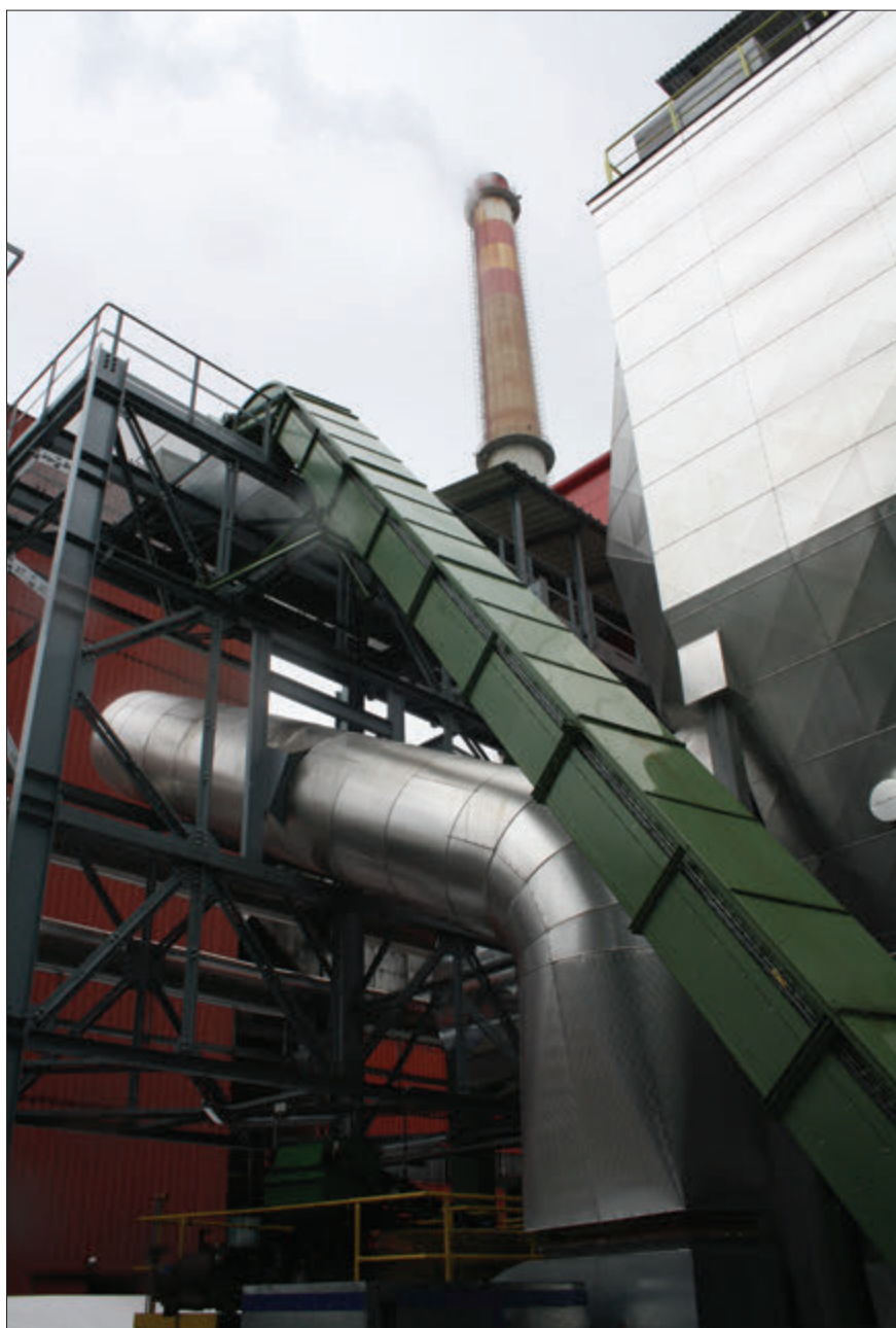
Bioelektrárna ve Sviadnově
